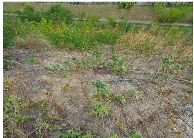
위 치 STA.0+850 1~2단 내 용 녹생토 식생불량, 능형망 노출
