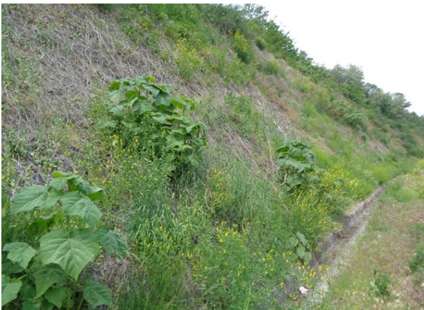
위 치 STA.0+650 2단 내 용 녹생토 식생불량, 배수관 노출
